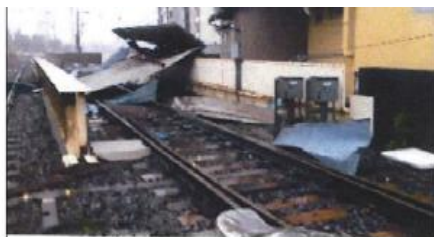
成田駅構内 (家屋倒壊・軌道内支障)
