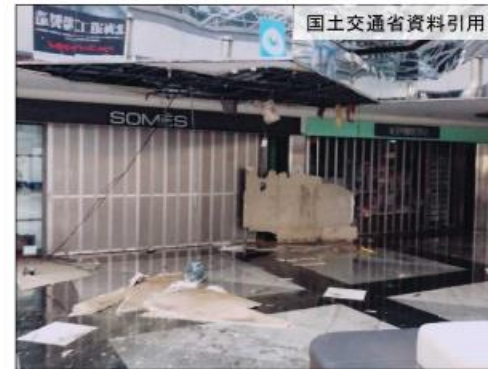
発災直後の国内線ターミナル内の様子
