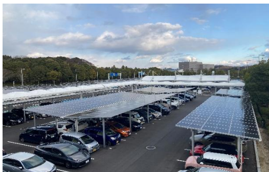
カーポート型太陽光発電設備
